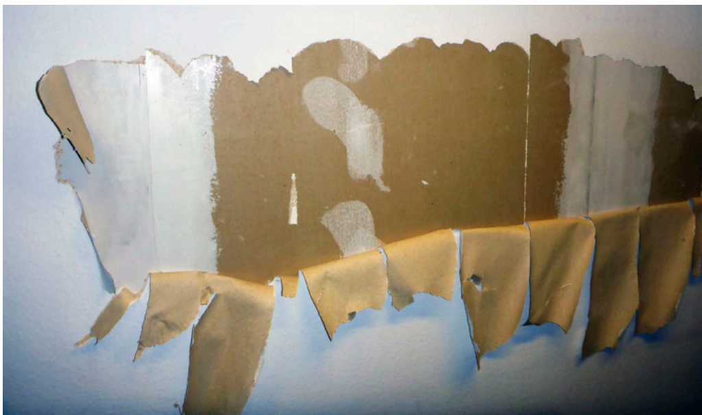
Gipskarton-Spachtelmasse hinter einer Tapete
