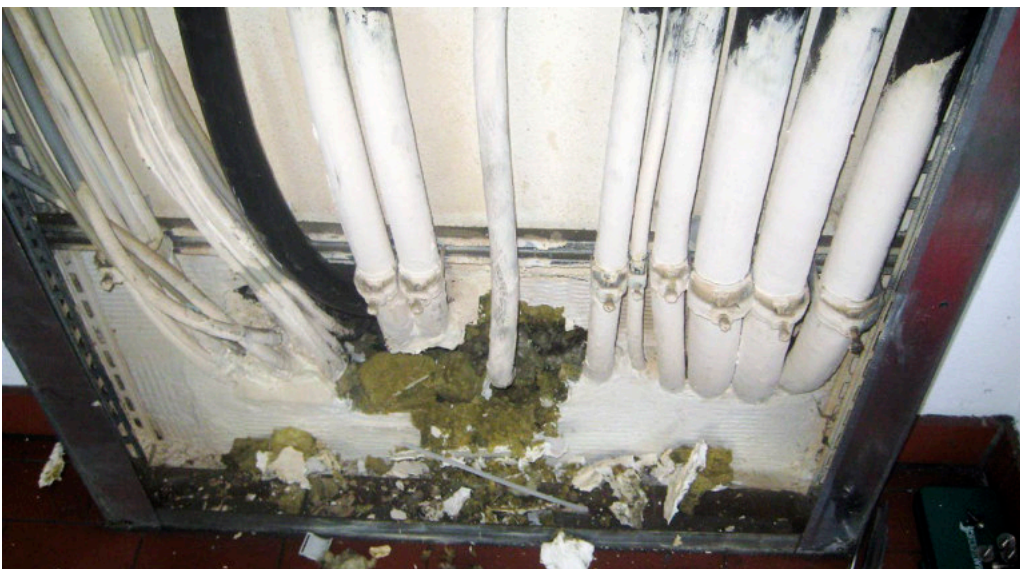
Kabelschott mit Asbest und künstlichen Mineralfasern (KMF)
