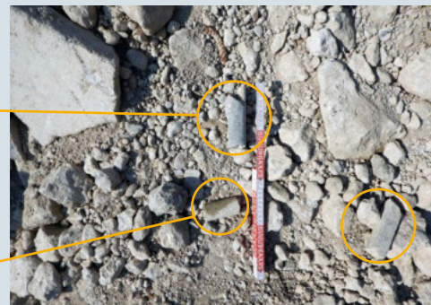
Bauschutt: Asbesthaltige Rohrhülsen und Abstandshalter
