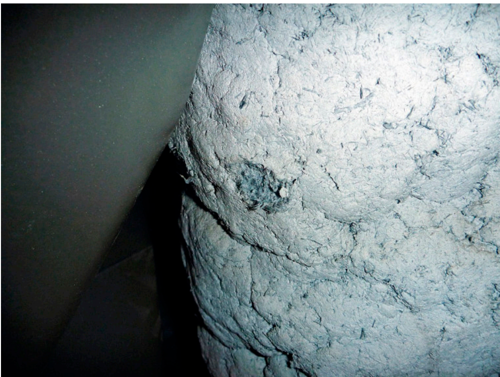
Schwach gebundener Asbest: Spritzasbest
