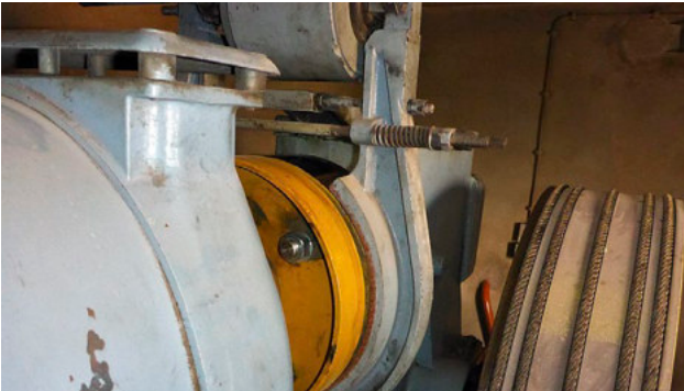
Aufzugsanlage mit asbesthaltigen Bremsbelägen
