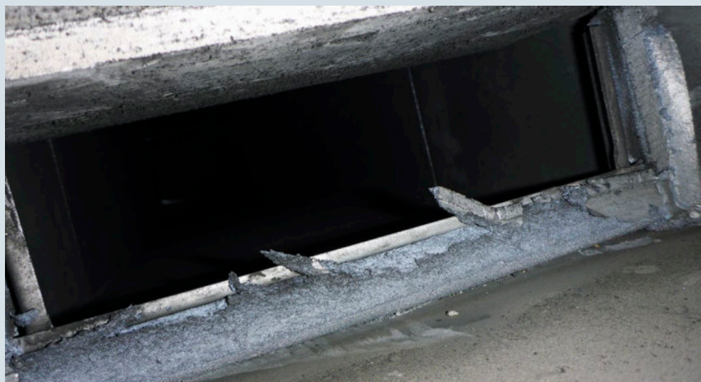
Brandschutzklappe mit stark beschädigter asbesthaltiger Anschlagdichtung
